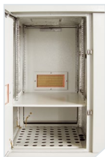
Телекоммуникационный отсек Отсек питания
